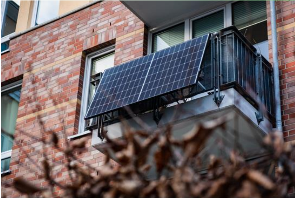
Foto: Balkonkraftwerk, Solarpanel an einem Mehrfamilienhaus (© Robert Poorten / Adobe Stock)
